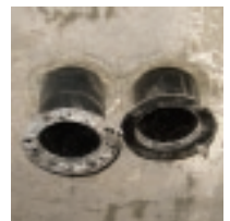
Sleeves stuck in concrete after pour
